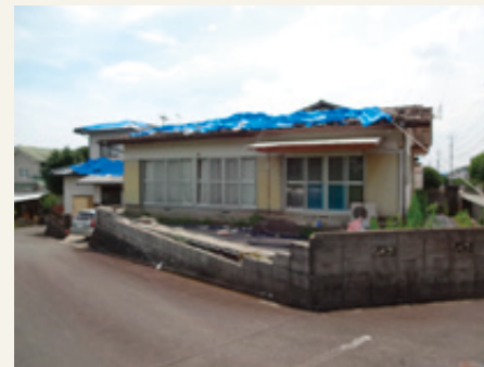
屋根の被害が最も多く、雨漏りがしないようブルーシートをかけて土嚢で固定した
