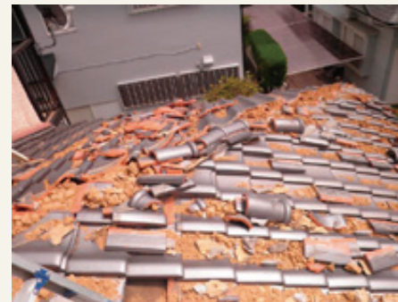
破損した瓦が多く散乱する屋根
